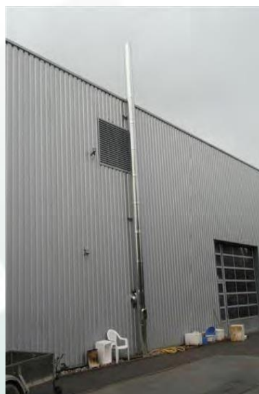
Aspirazione di aria fresca da un canale centrale attraverso un'apertura di areazione con una griglia nel muro esterno.
