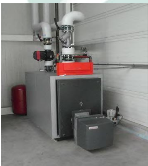
Esempio di boiler per il riscaldamento centralizzato di due sezioni.
