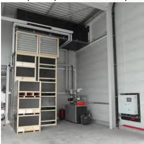
Impianto di essiccazione per due sezioni con riscaldamento centralizzato.
